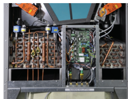
Výměník tepla a zásobník kondenzátu
